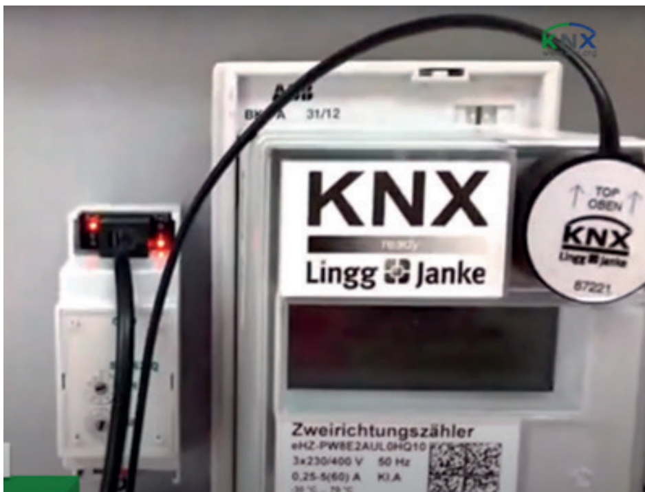
La testa ottica legge i dati dal contatore e li trasmette al bus KNX, come indicato dal LED rosso acceso in alto a sinistra.
