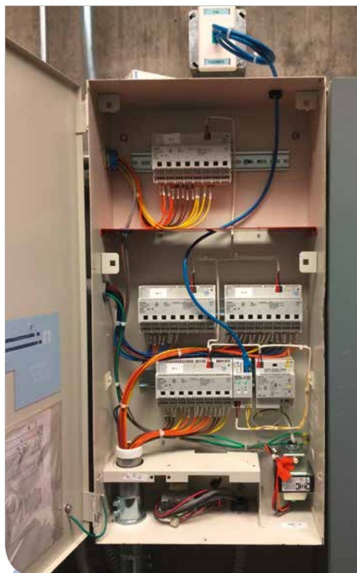
Das GAMMA System ermöglichte eine verteilte Steuerungsarchitektur, durch die alle Anforderungen an die Beleuchtungssteuerung des Stadions erfüllt werden konnten.
