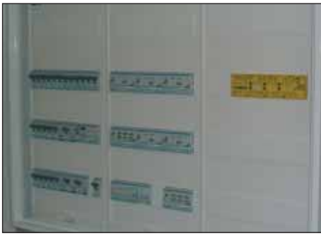
Bild 2. KNX-Komponenten in der zentralen Wohnungsverteilung
