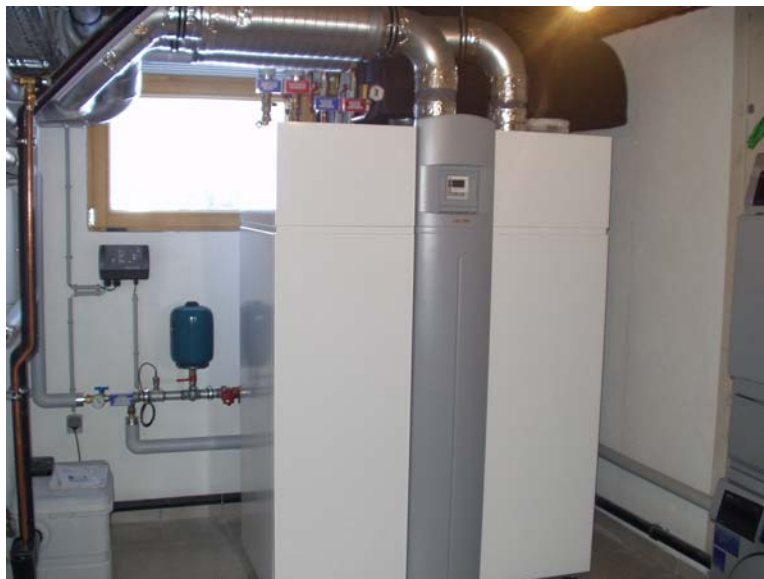
Bild 2. Die Einbindung der Luft/Wasser-Wärmepumpe in die kontrollierte Wohnraumlüftung mittels KNX schafft die Grundlage für sehr günstige Verbrauchsdaten / Figure 2. The integration of the air/water heat pump into the room ventilation controlled via KNX is the basis for the low energy demand
