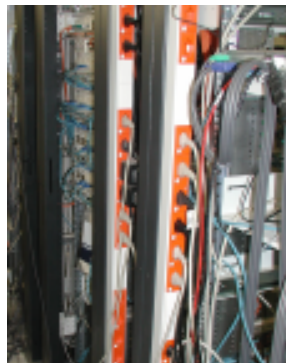
Blick in den Serverraum: Komfort und Sicherheit durch umfangreiche, vernetzte Technik
