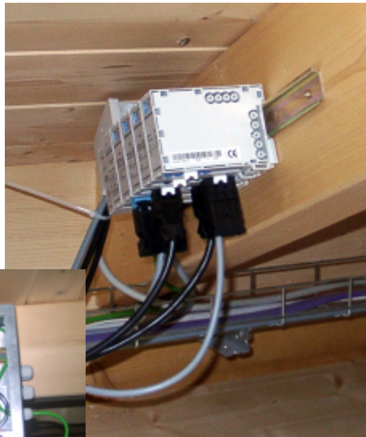
Wieland Gesis Modular-, Dimm- und Schaltaktoren am ecobus-Kabel
