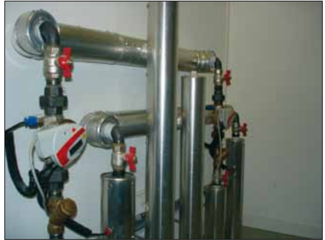
Figur 1. Värmemätning med M-Bus gränssnitt och M-buss-KNX port
