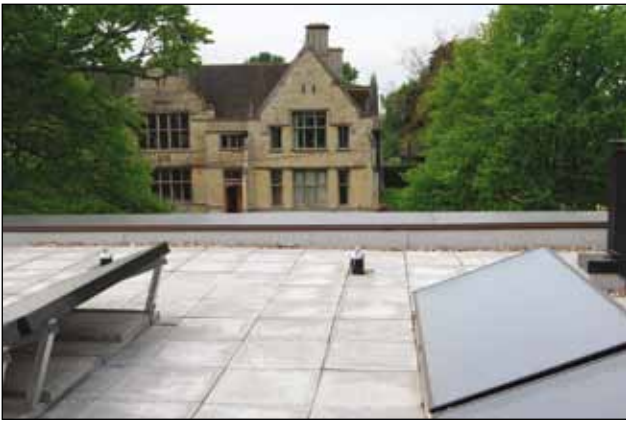
Figura 4. Recursos sostenibles: paneles solares para el servicio de suministro de agua caliente Fuente: Andromeda
