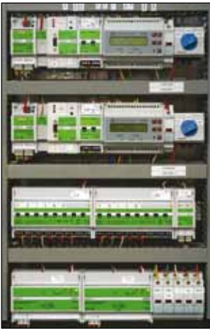
Figura 3. Componentes KNX en la sala de medición de la planta superior Fuente: Schäcke
