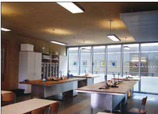
Figura 2. Eficiencia energética 1: regulación constante de la iluminación en los laboratorios con KNX. Fuente: Andromeda
