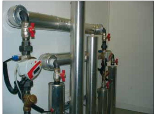
Wärmezähler mit M-Bus-Schnittstelle und M-Bus-KNX-Gateway
