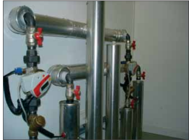
Wärmezähler mit M-Bus-Schnittstelle und M-Bus-KNX-Gateway
