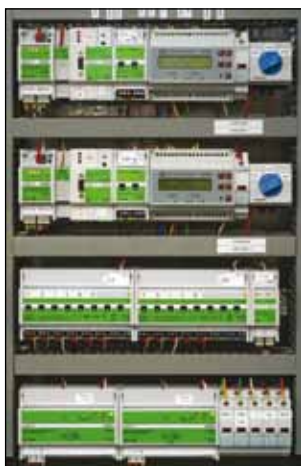
Rys. 3. Komponenty KNX w pokoju pomiarowym na ostatnim piętrze. Źródło: Schacke.
