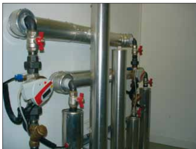
Rys. 1. Czujniki ciepła z interfejsem M-BUS i bramką M-BUS-KNX-Gateway.
