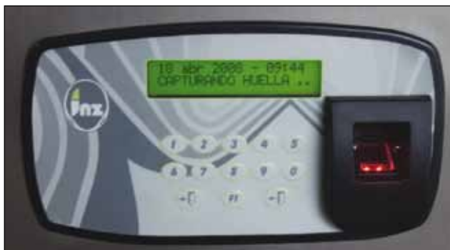
Rys.4. Dzięki interfejsowi kontroli dostępu (odcisk palca) do systemu KNX, możliwe jest sterowanie wszystkimi systemami.
