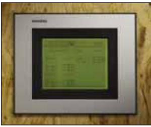
Bild 4. Die zentrale Steuerung der Gebäudesystemtechnik befindet sich gut geschützt im Technikraum. Im Schulgebäude ermöglichen Touch Panels den Zugriff auf alle wichtigen Funktionen.
