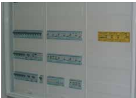
Bild 2. KNX-Komponenten in der zentralen Wohnungsverteilung
